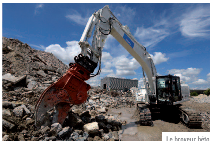
Le broyeur béton
