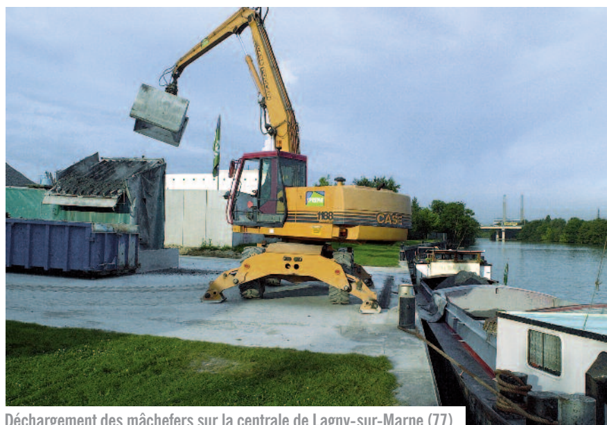
Déchargement des mâchefers sur la centrale de Lagny-sur-Marne (77)
