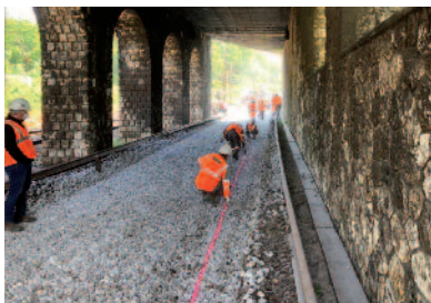
Préparation de la voie pour mise en œuvre de la Grave SNCF YPREMA
