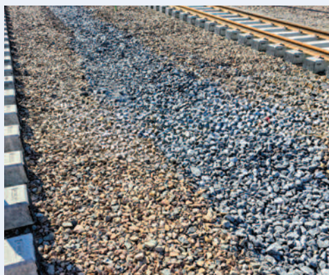
Tranchée d'infiltration entre les faisceaux ferroviaires
